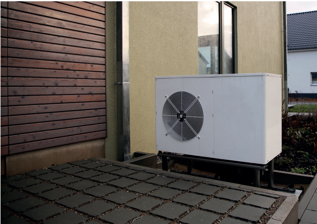
Abb.50 - Das ist die Luft-Wasser-Wärmepumpe am Faktor X-Haus in Inden
